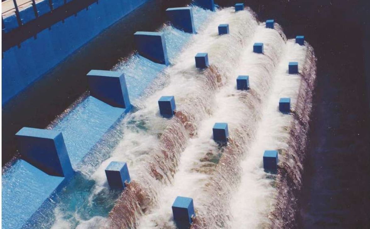
Resim 3.42: Su arıtma sistemleri
