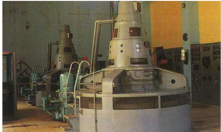
Resim 7.9: Elektrik santrali dinamosu
