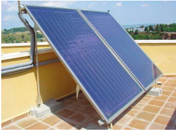
Resim 6.15: Güneş enerjisi ile su ısıtma sistemi
